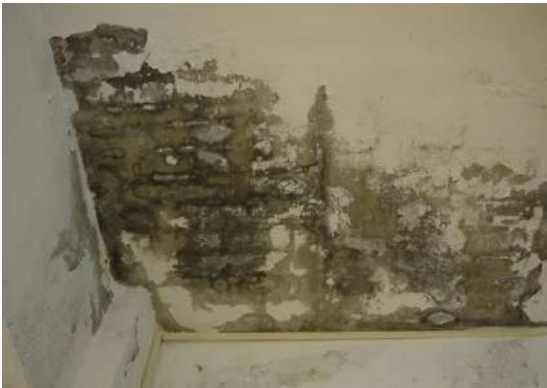
頂層防漏水失效
