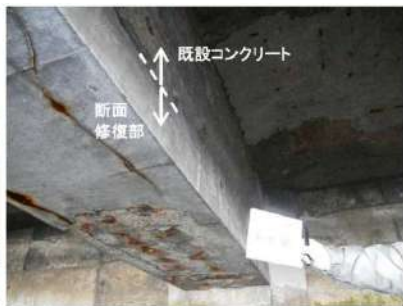
(b) 主筋に沿う腐食ひび割れや錆汁
