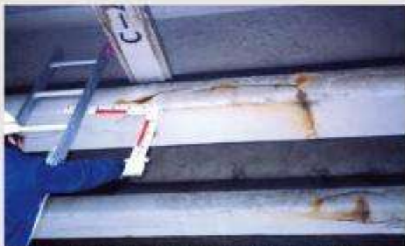
▶マクロセル腐食*で再劣化。補修箇所のさび流出
