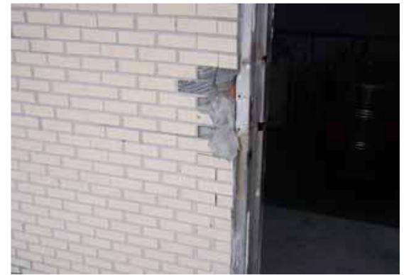
門框周邊受損
