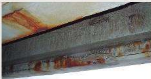
▶PC桁に橋軸方向のひび割れ。PC鋼材の腐食
