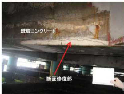
(a) かぶりコンクリートの浮き・剥離
